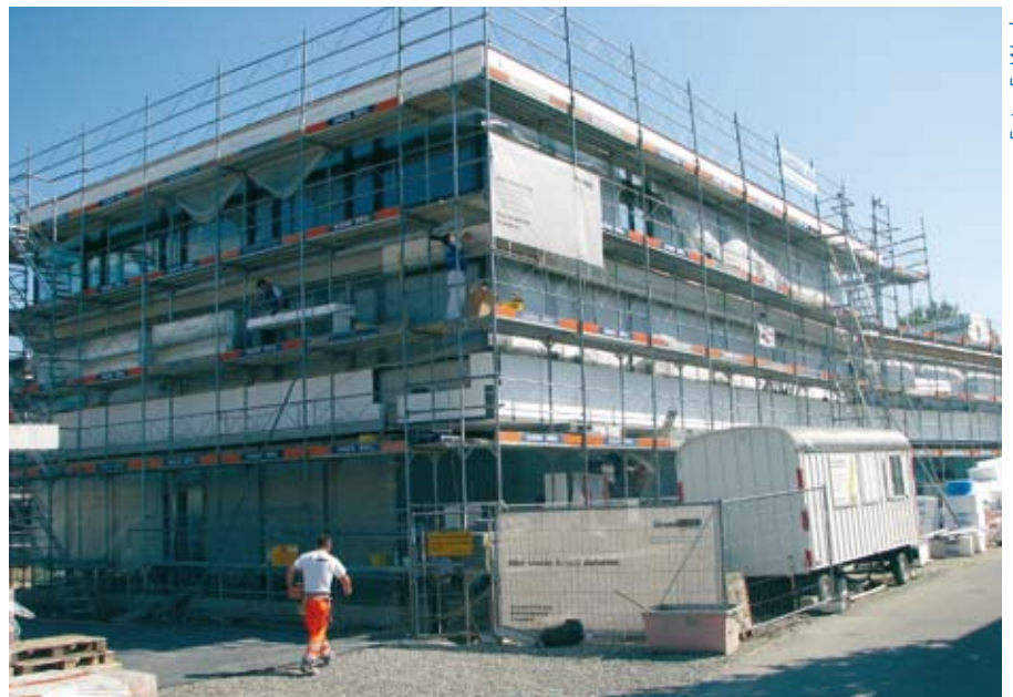
Mitte Juni wird weiter an der Fassade des Neubaus gearbeitet, im Parterre der Tagungsraum
